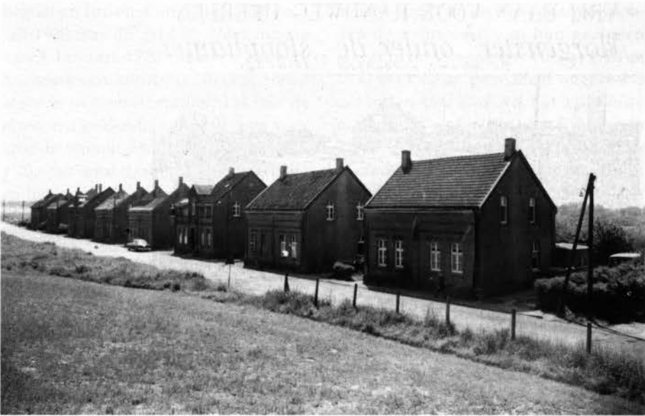
De buurt Morgenster tijdens de sloop. De woningen links zijn reeds gedeeltelijk gesloopt (Fotocollectie SAH no. 6985, opname 8 juni 1962).
