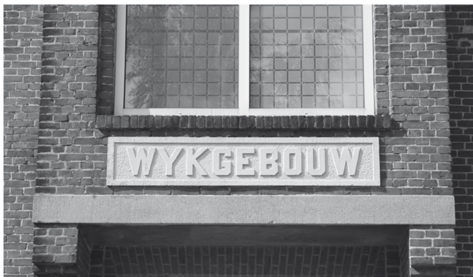
Detail van de huidige gevel van Kapelaan Berixstraat 16 in Heerlen, lange tijd het eerste wijkgebouw van het Groene Kruis. foto: Ton van Mastrigt
