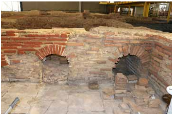
Reconstructie scheidingswand: Met de replica dakpannen kon de boogconstructie van de verdwenen muur tussen de lauwwarme en de warme ruimte weer helemaal teruggebouwd worden.
